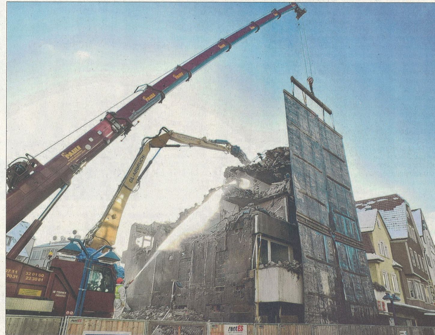
Gestern noch da, heute schon weg: Mehrere Gebäude an der Stuttgarter Straße müssen Wohn- und Geschäftshäusern weichen. Foto: Tom Bloch
